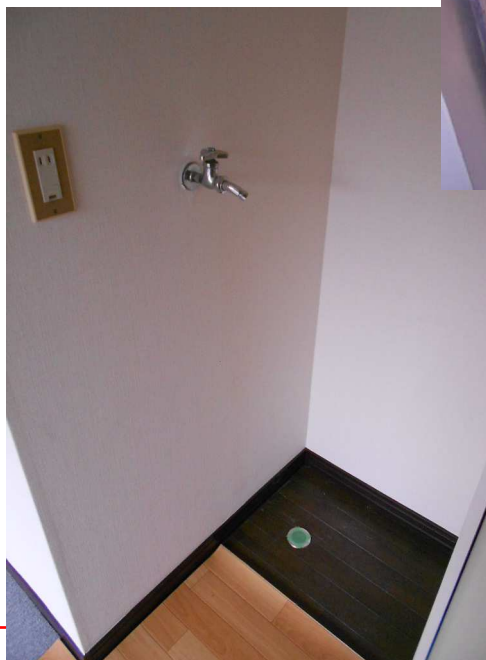
左側写真 室内洗濯機置場
